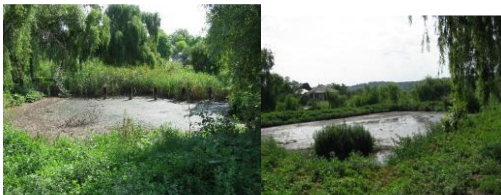
Figură 4-2 : Platforme de nămol supraincarcate (sistemul de drenare nu functioneaza) (Sursa: Imaginea este executata de ECOPSIS)
